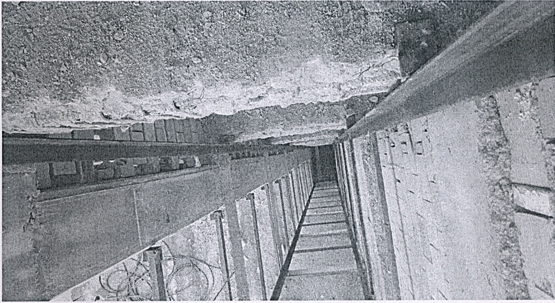
شکل ۱- تخریب پوتر برای نصب آسانسور به علت عدم دقت در جانمایی و کنترل ابعاد چاله آسانسور
