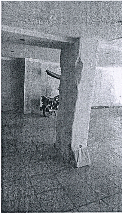
شکل ۲- تخریب ستون برای تامین دهانه پارکینگ، به علت عدم دقت در اجرای ستون ها یا عدم احتساب نازک کاری در حین اجرا.
