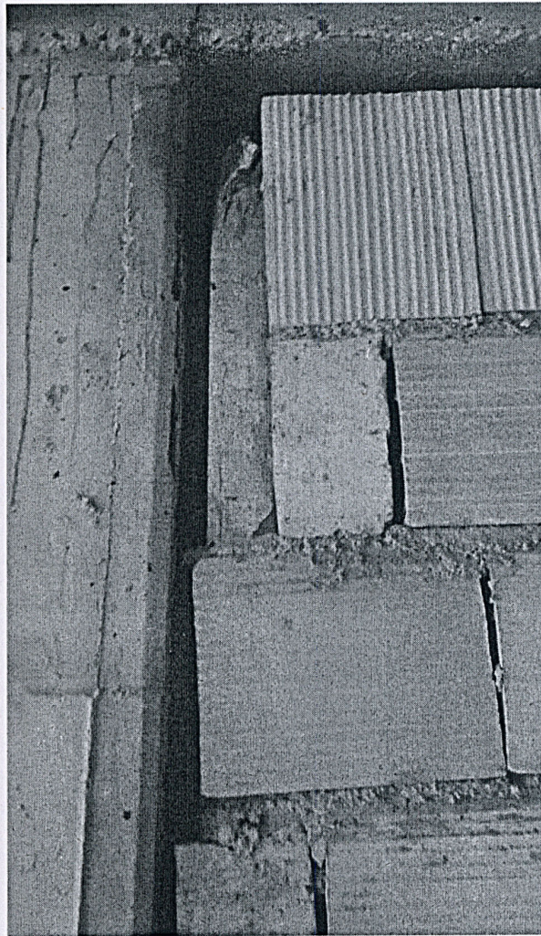
شکل ۱۵- عدم درزبندی صحیح و عدم اجرای بندکشی قابم دیوار بین واحد های مستقل از لحاظ عایق بندی صوتی
