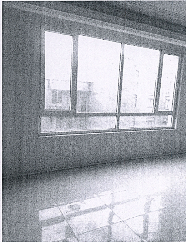
شکل ۹- عدم رعایت ارتفاع پنجره از کف و بزرگی بیش از حد.
